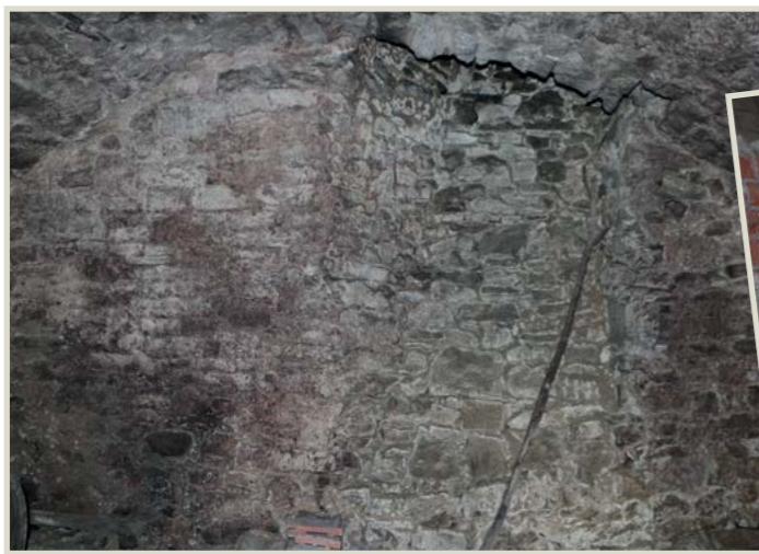
Luftschacht an der geraden Wand im Keller und gemauertes Schachtende in der Scheune darüber
